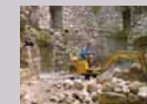
Depositi di materiale di crollo all'interno del torrione principale
