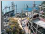
Da sinistra: Stato conservativo dei profili a rudere. Introduzione di connettori in acciaio inox per il consolidamento delle parti smosse. Il perimetro sommitale del bastione interessato dalla presenza della vegetazione
