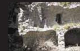
Depositi di materiale di crollo all'interno del torrione principale
