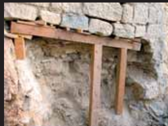
Mancanza fondale del paramento sotto la ricostruzione dei primi decenni del novecento realizzata sui crolli
