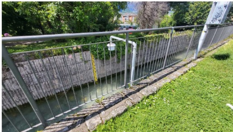
FOTO 22. Torrente Albola. Stazione idrometrica e di rilevamento della portata
